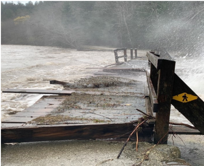
Passerelle démolie pendant la crue
